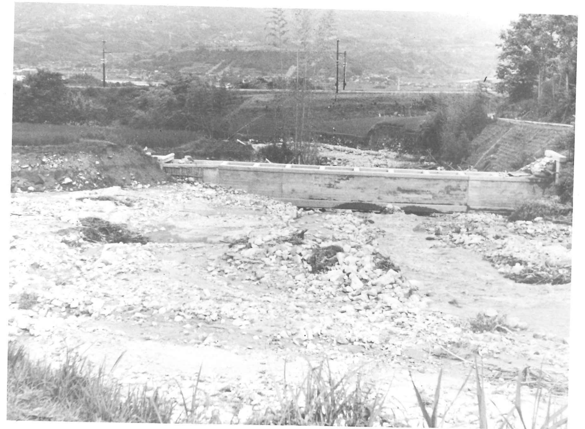
一貫水路橋。土石流により埋まってしまった。(土曾川)
