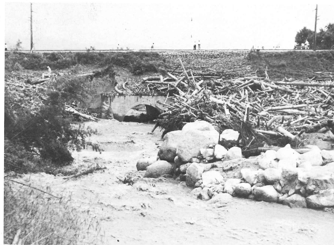
国鉄飯田線隧道。馬に乗って通れる位の高さがあったが、災害でこの通り。
