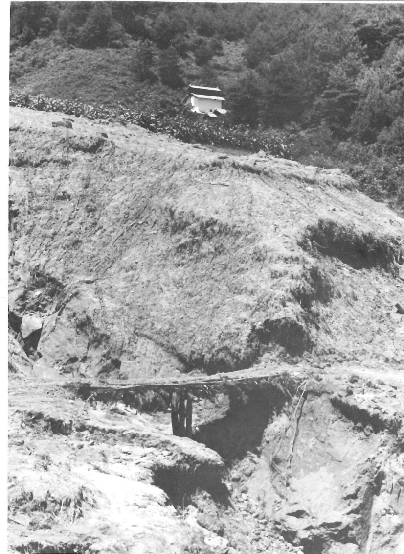
山田 (鋤柄さん畑の下)。道路が深く切断された。(仮橋は応急措置)
