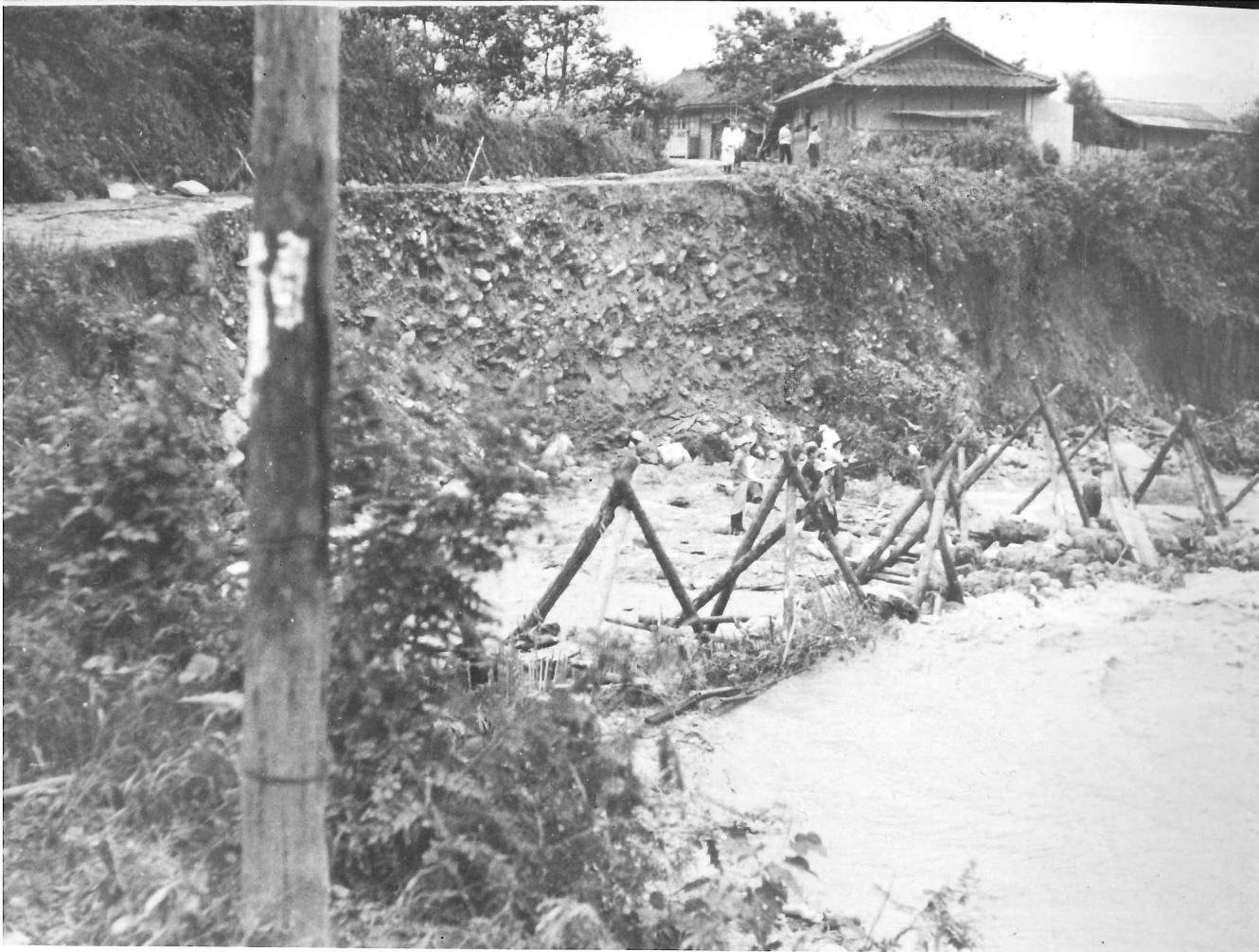
野底橋下。県道も崩落し、交通が遮断された。
