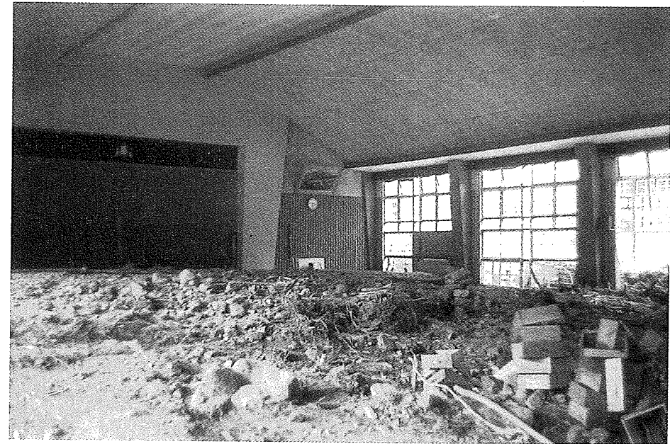
土砂で埋まった鹿塩中学校体育館
