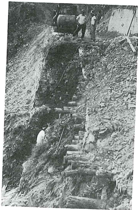
治山運搬道(園原線)の被害と復旧状況 (飯田営林署管内)
