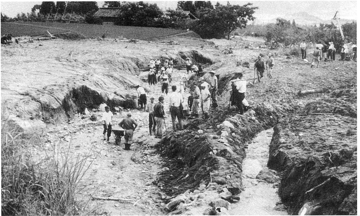
↑ 米の沢入口附近の氾濫と仮復旧作業
