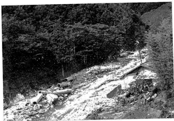
破壊された導水管
